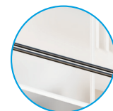
Tubazione del refrigerante
